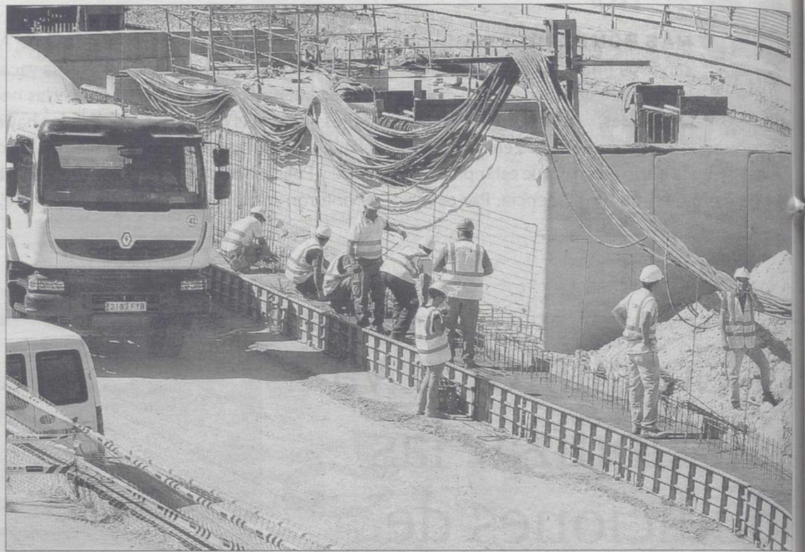
Obras de construcción de la futura estación del AVE en Albacete capital. / A. PÉREZ
