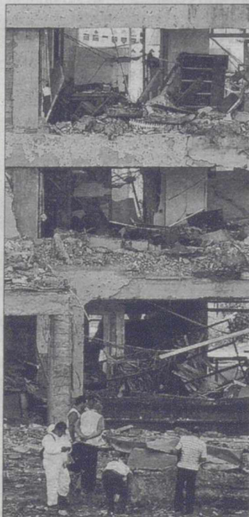
Los técnicos inspeccionan los daños.
