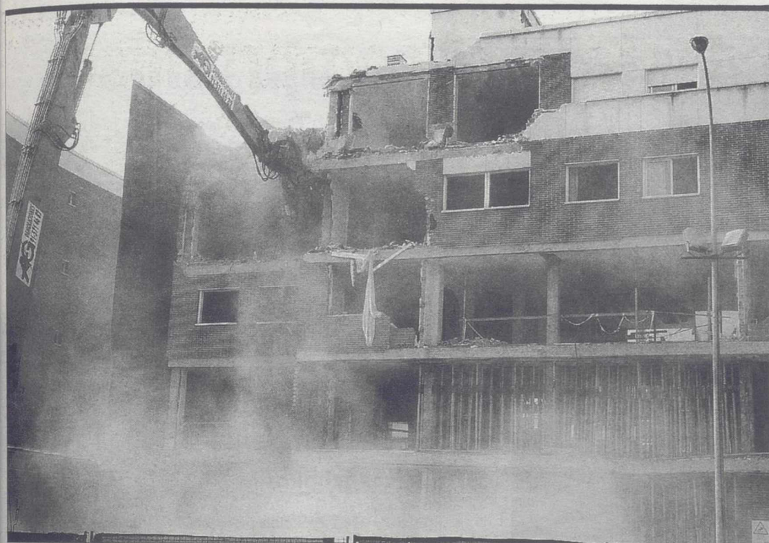
Derriban el edificio de Leganés. Ayer por la mañana comenzó el derribo del edificio de Leganés (Madrid) donde se suicidaron siete terroristas islamistas el pasado 3 de abril. En la explosión también falleció un miembro de los GEO de la Policía Nacional. Los trabajos de derribo del inmueble, cuya estructura resultó muy afectada por la deflagración, se prolongarán durante una semana. / FOTO: J. L. PINO (EFE)
