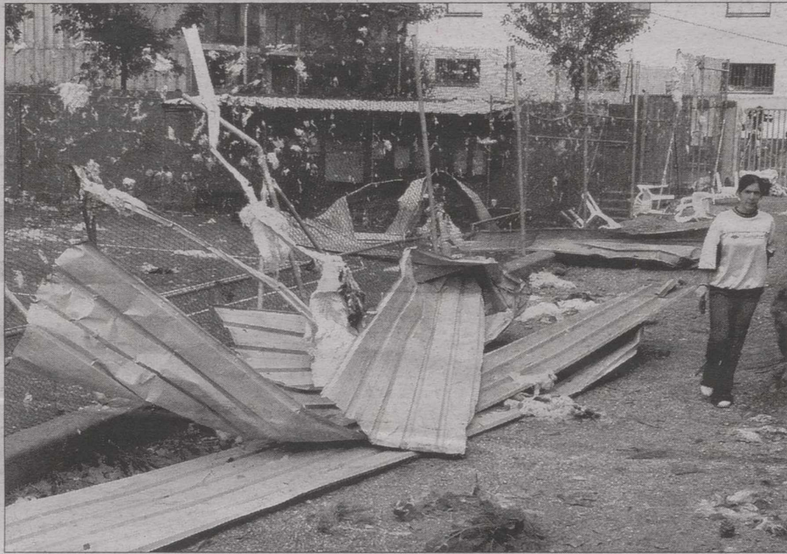
El techo del polideportivo municipal de Hostalets de Balanya (Barcelona) se desplomó debido a un tornado. /A. OLIVE (EFE)
