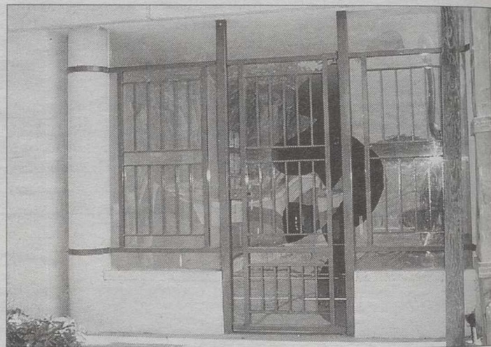
Los destrozos se extienden a la puerta principal del recinto./A. ROMERO
