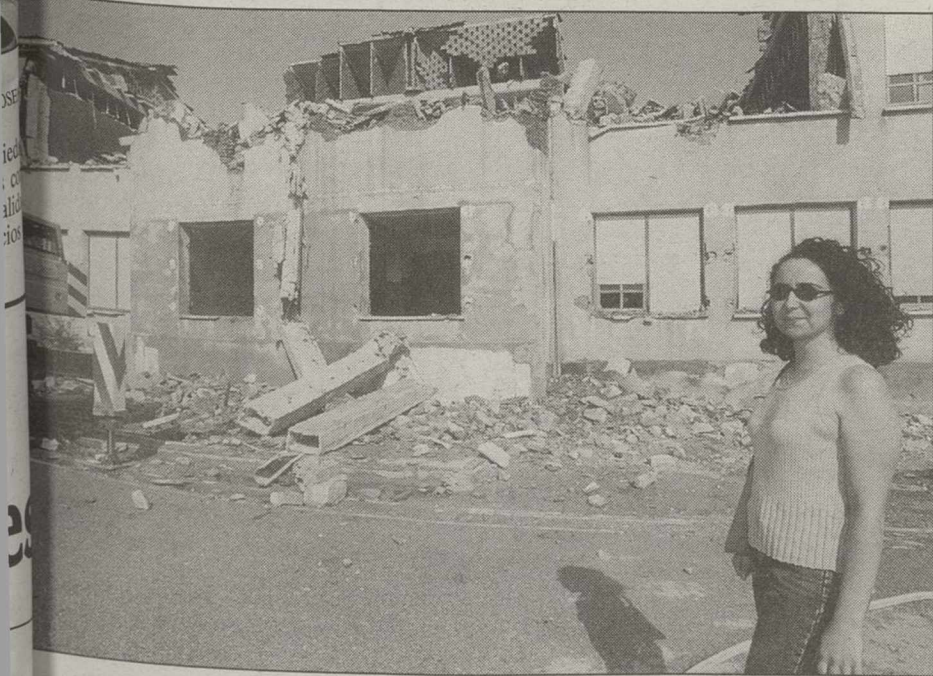
La alcaldesa de Barrax, Etelvina Avendaño, asistió a la demolición del edificio.
