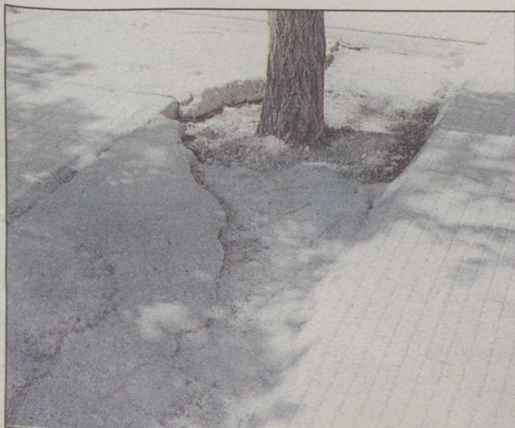
Las obras de pavimentación no se han rematado.
