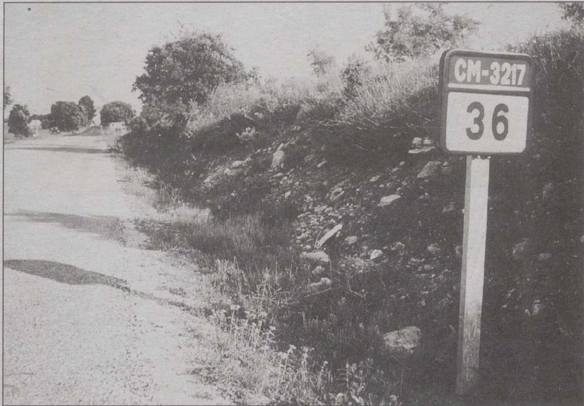
La central advierte que el mal estado de la carretera es un riesgo para los jornaleros que se desplazan a Murcia.
