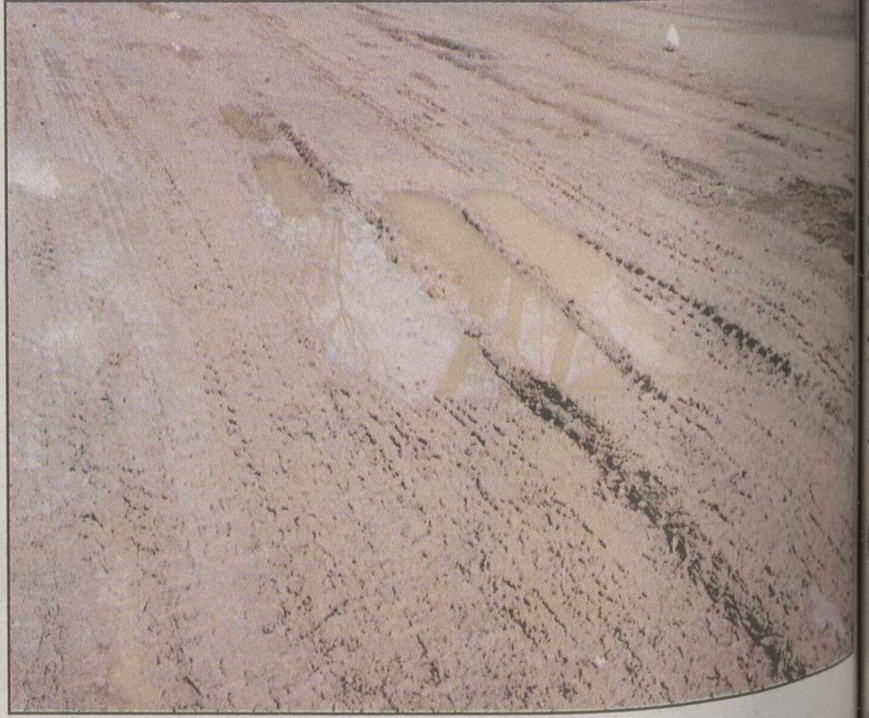
Las huellas de los vehículos se quedan así para los restos.
