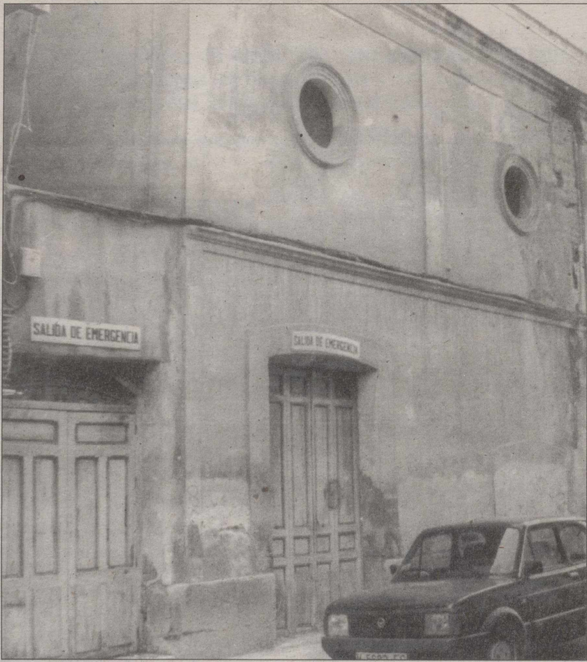
Parte trasera del edificio: nuestro Teatro Circo necesita, efectivamente, una "salida de emergencia" a su deterioro.
