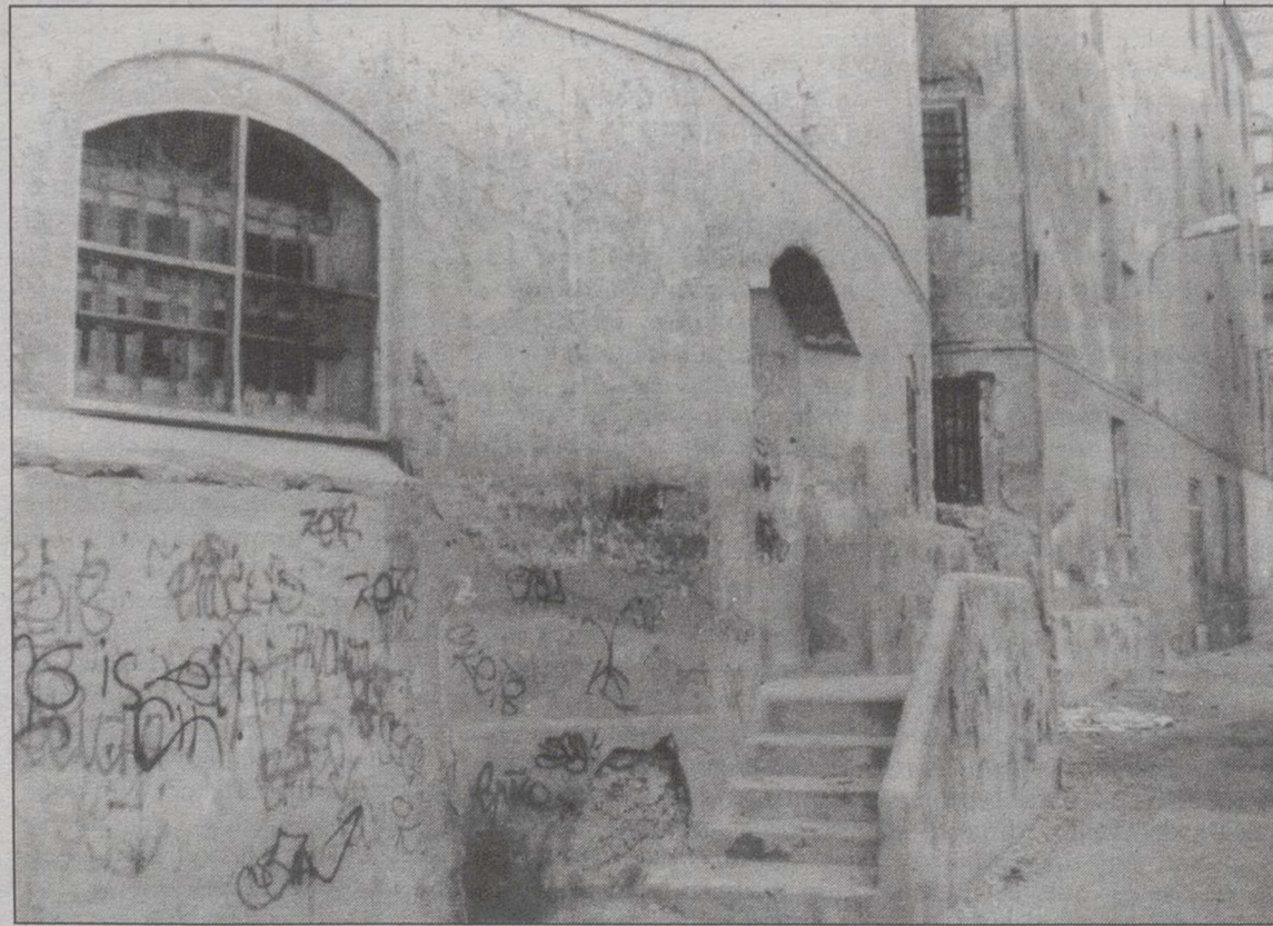
El Callejón del Teatro Circo presenta hoy este lamentable estado.
