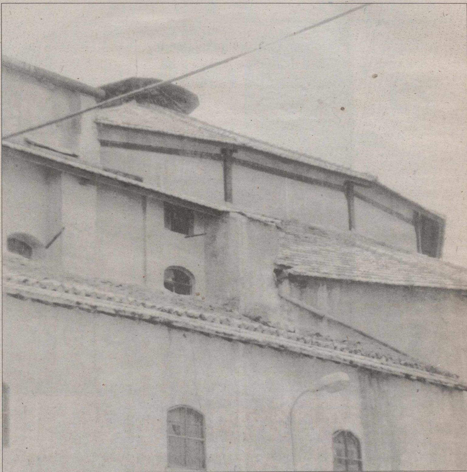
Los elementos que aún permanecen del primitivo proyecto, como la cúpula, son los que están mejor conservados.
