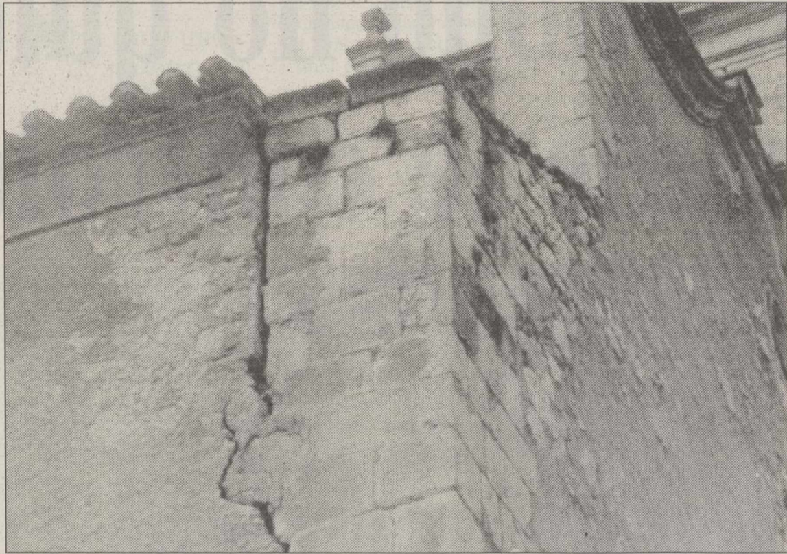
Otros terremotos han causado daños en nuestra provincia.
