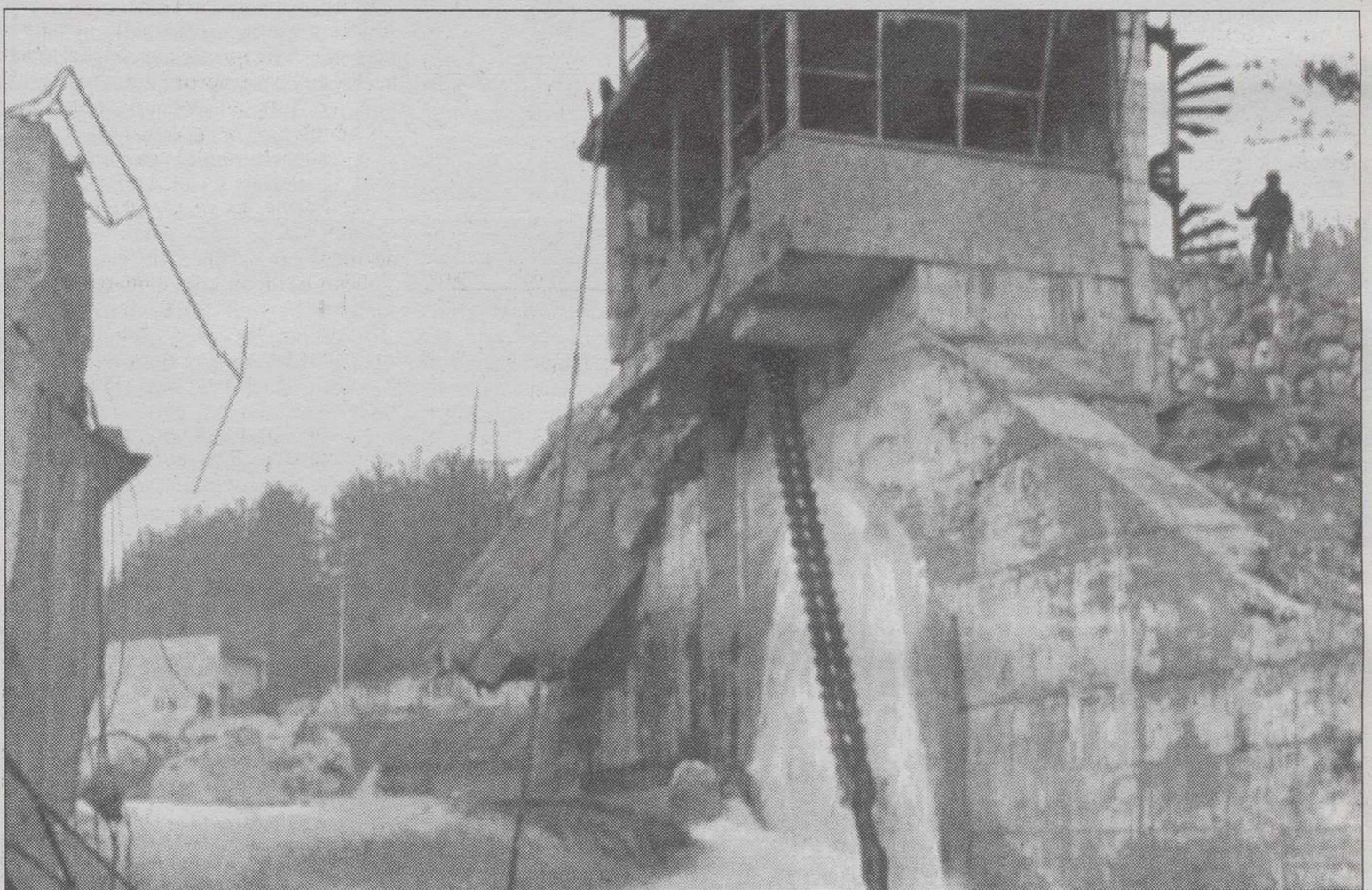
Las tres grietas que se abrieron en la presa por las explosiones podrían hacer que la estructura del embalse cediera por el fuerte empuje del agua.
