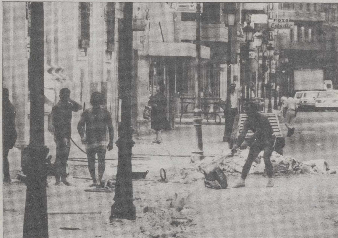
Las obras se han iniciado en una de las aceras que une la Plaza de Gabriel Lodares con la calle del Tinte.
