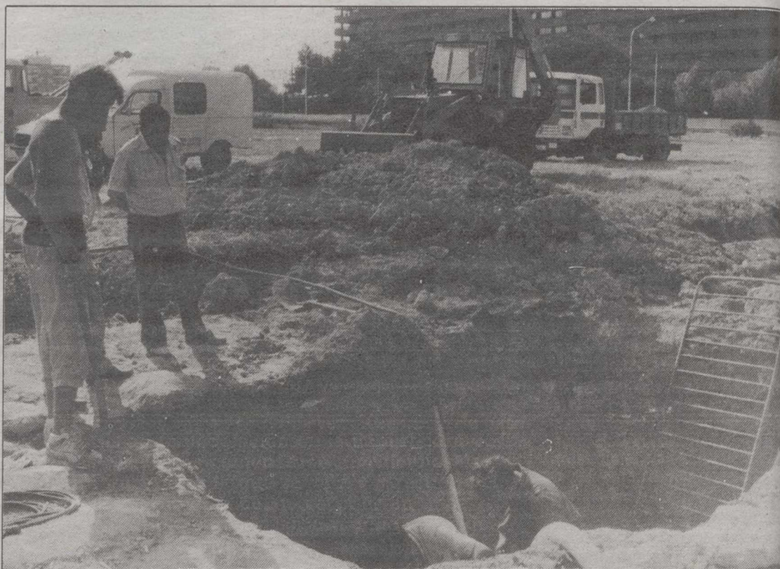
La rotura de la tubería arrojó bruscamente grandes cantidades de agua sobre las huertas que se disponen frente al Hospital General
