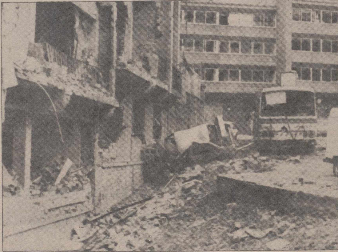
El Cuartel de la Guardia Civil sufrió graves daños.
