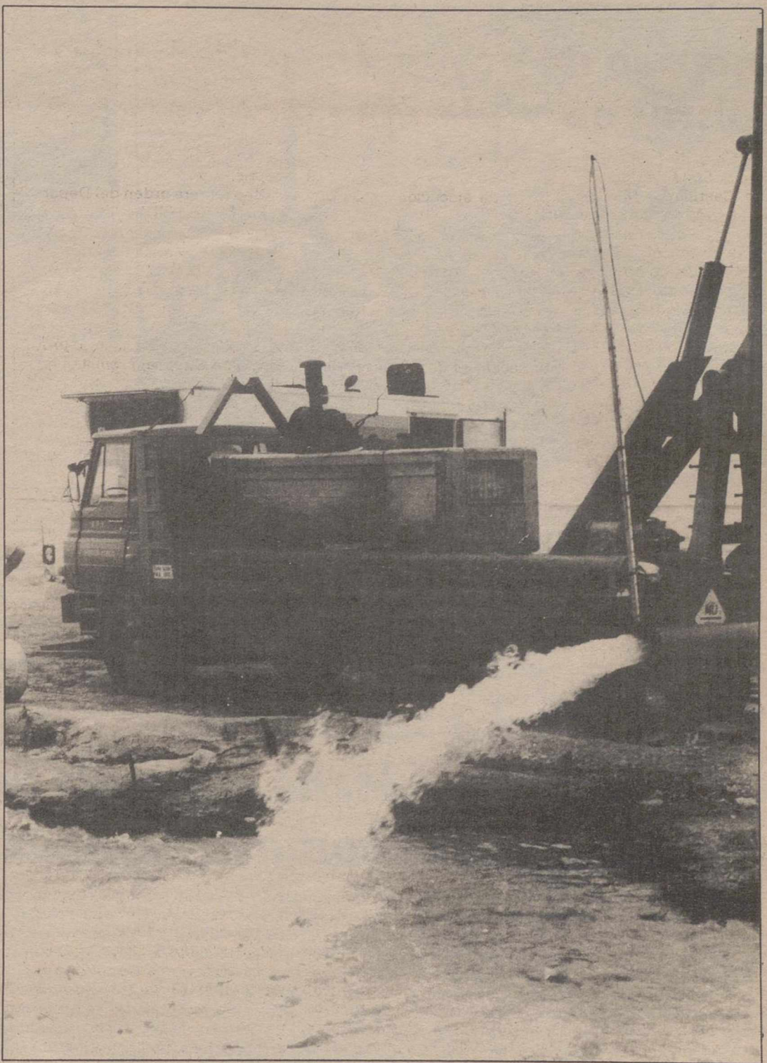
Tren de aforo y grupo electrógeno mediante el cual se extraen con ayuda de una bomba situada a 70 metros de profundidad los 200 litros de agua por segundo.
