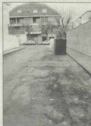
Estado de la calle Extremadura.
