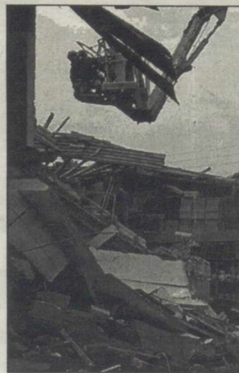
El edificio quedó destruido
