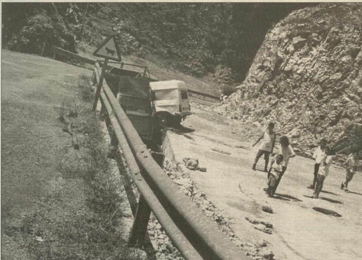
Algunos de los efectos de las inundaciones.
