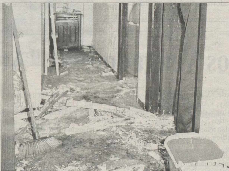
Estado en que quedó la vivienda.
