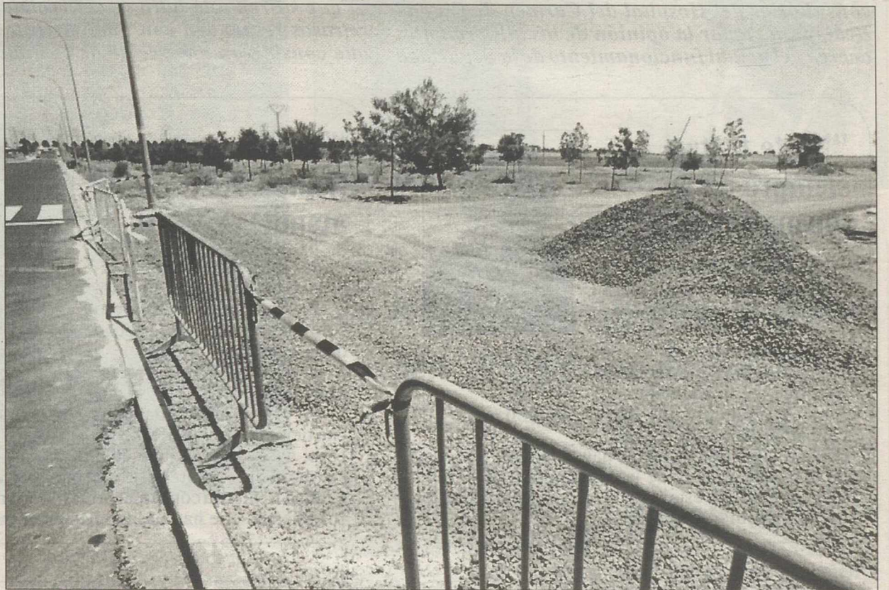
En el terreno se ha abierto un camino de acceso alternativo y se ha desviado una conducción de agua.
