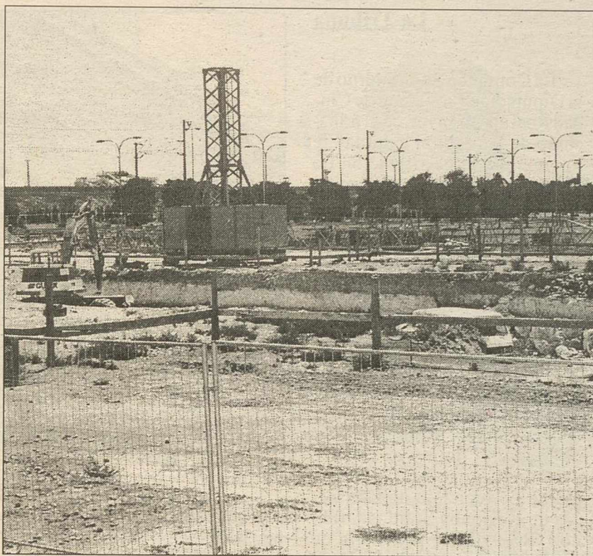
Los terrenos han resultado ser muy sueltos para la cimentación.
