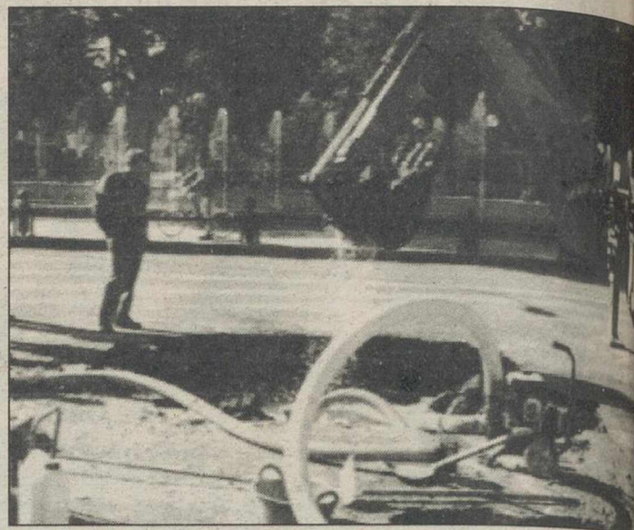
La rotura se produjo en la Ronda de Alarcos.
