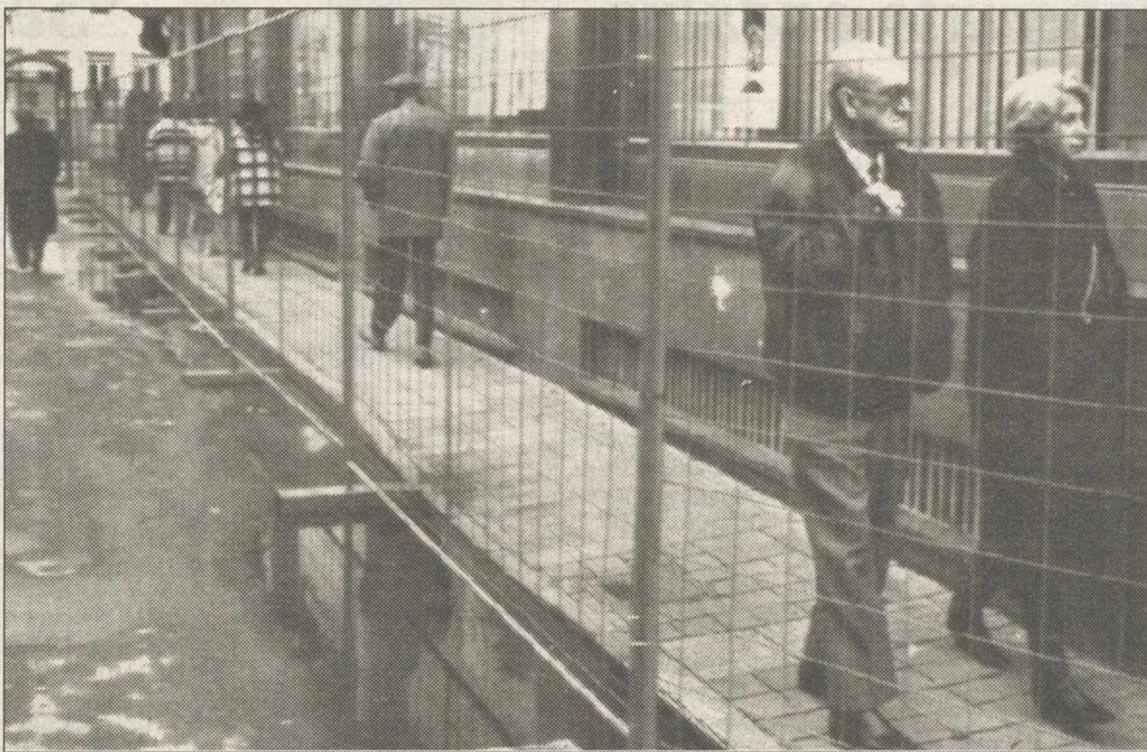
Las obras para la definitiva peatonalización de las calles ya han comenzado.
