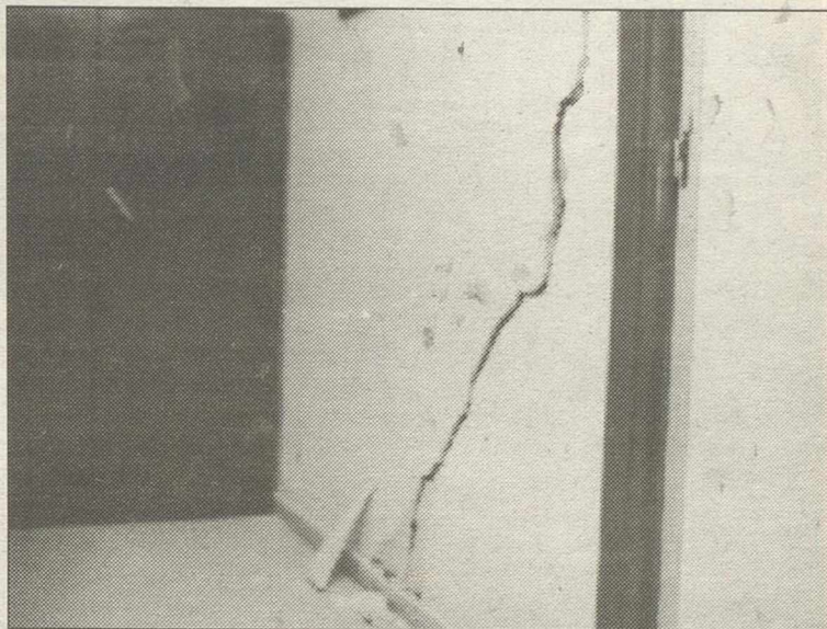
Las grietas en el colegio son numerosas
