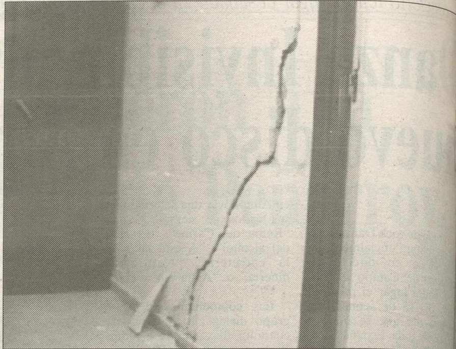
RUEDA - Las grietas en el colegio son numerosas.
