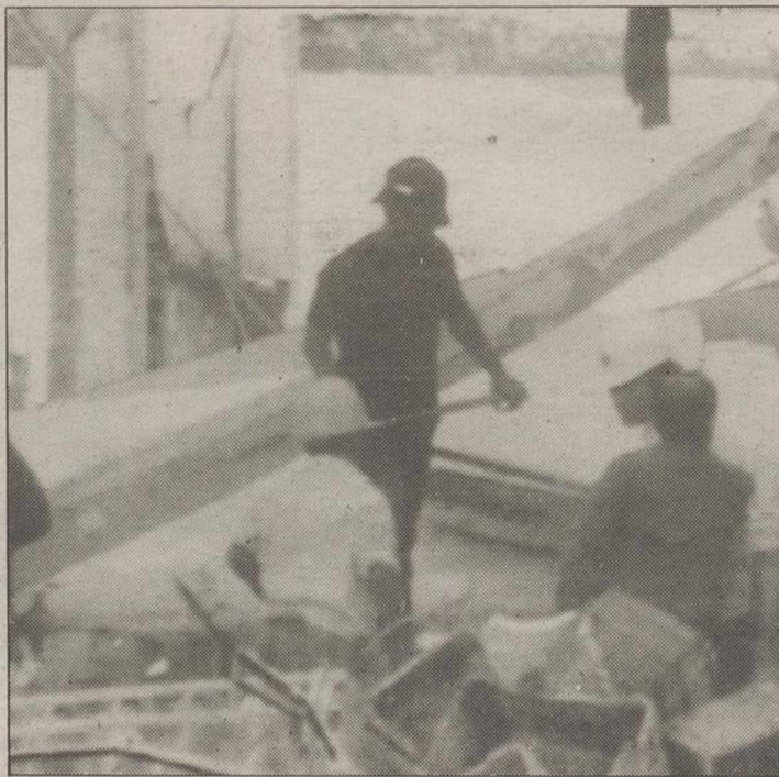
La explosión pudo haber ocasionado una tragedia.
