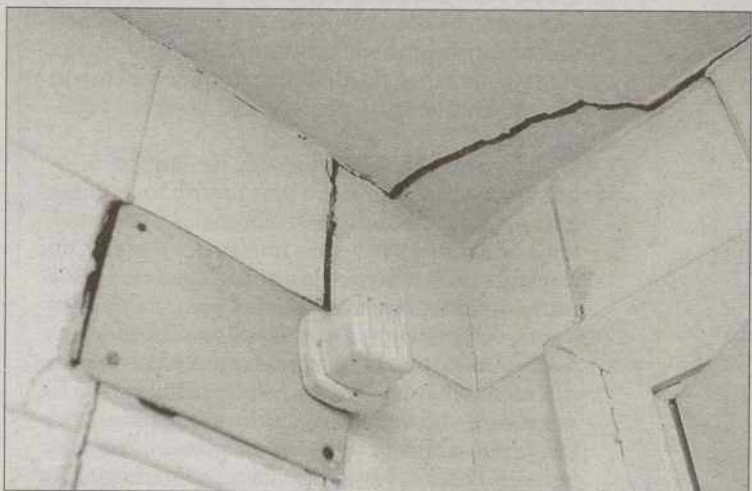
Una de las grietas de la cocina de un primer piso. /DAVID PÉREZ
