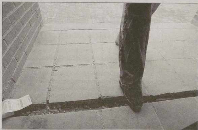
La brecha abierta entre el patio y el inmueble. /D. PÉREZ
