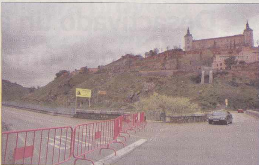
La caída de piedras obliga a cortar la carretera del Valle
