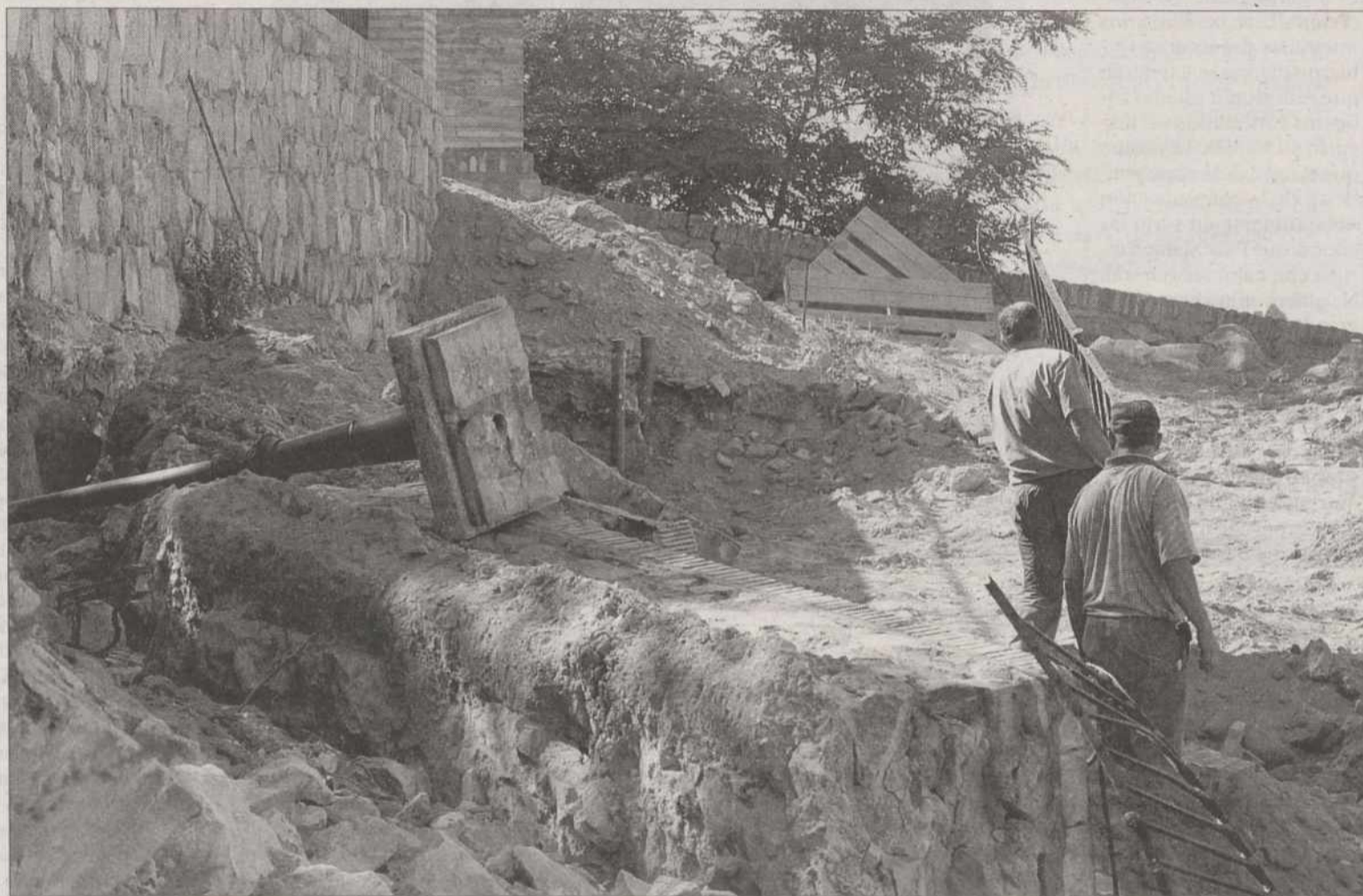
Los tres grupos políticos aprobaron por unanimidad las obras de pilotaje del terreno de Descalzos para evitar nuevos accidentes. / YOLANDA REDONDO
