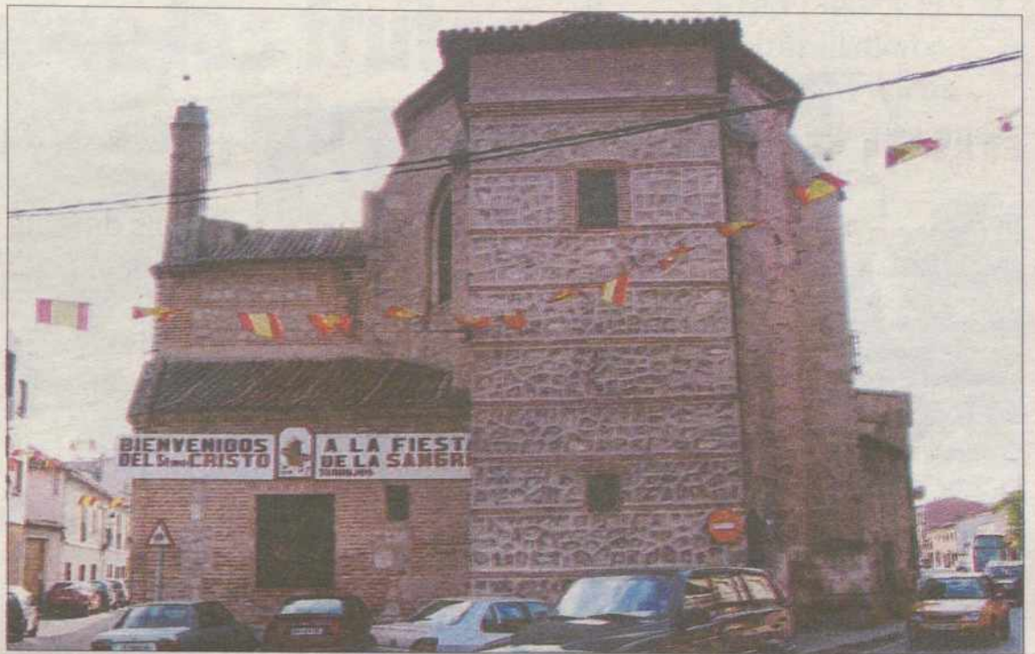
La recuperación de las pinturas, que conllevaría el arreglo del tejado, requeriría una inversión de 130.000 euros./ N.N.
