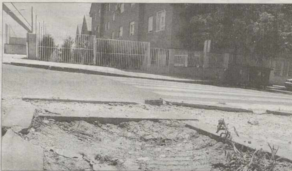
Las maniobras 'ilegales' de los camiones han causado desperfectos en la mediana.
