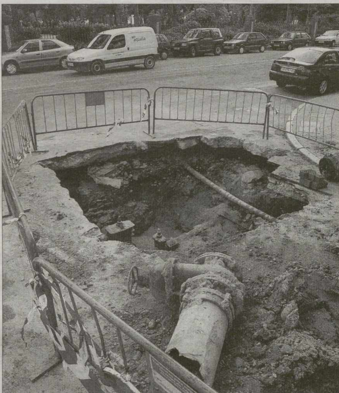
El enorme socavón de la avería -en el Paseo de Extremadura- aún permanece abierto. / MANU REINO
