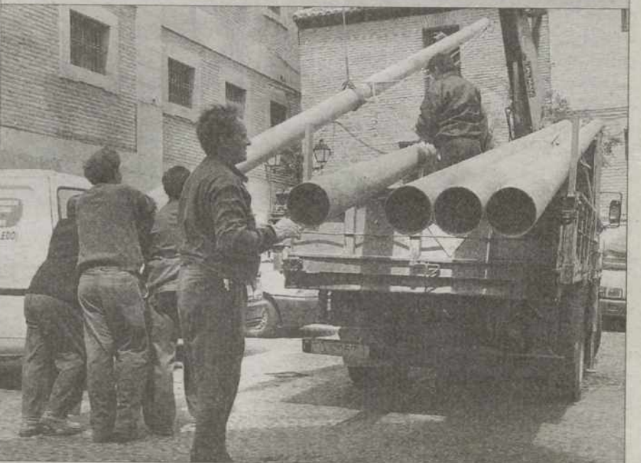
Preparando el Corpus. La llegada del Corpus está cada vez más cerca y como manda la tradición, los operarios del Ayuntamiento ya están perfilando la instalación de los toldos que marcan el trayecto de la procesión por las calles de la Ciudad Imperial. El primer paso, colocar los soportes, los que se ven en la imagen, sobre los que se asentarán estos toldos. Empieza la cuenta atrás. / VÍCTOR BALLESTEROS
