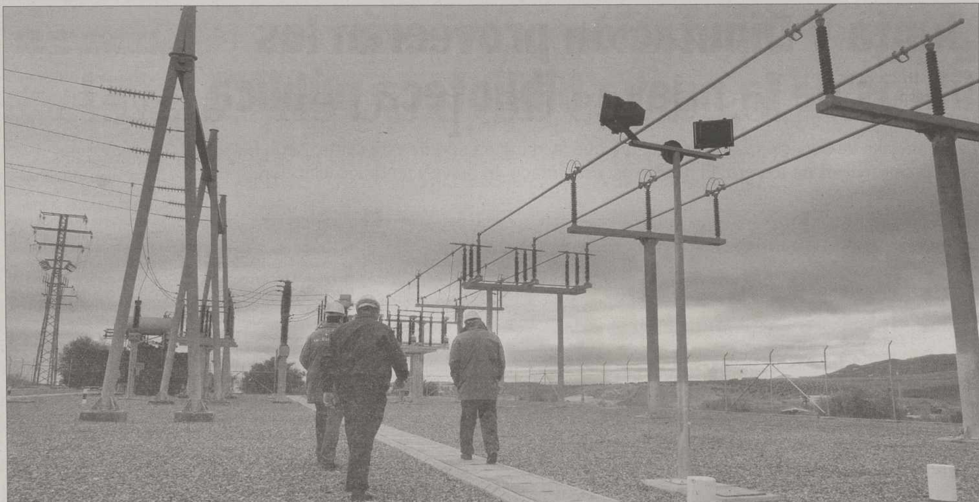
Un grupo de operarios durante la visita de ayer a las instalaciones de Iberdrola situadas en el término municipal de Los Navalmorales. / MANU REINO
