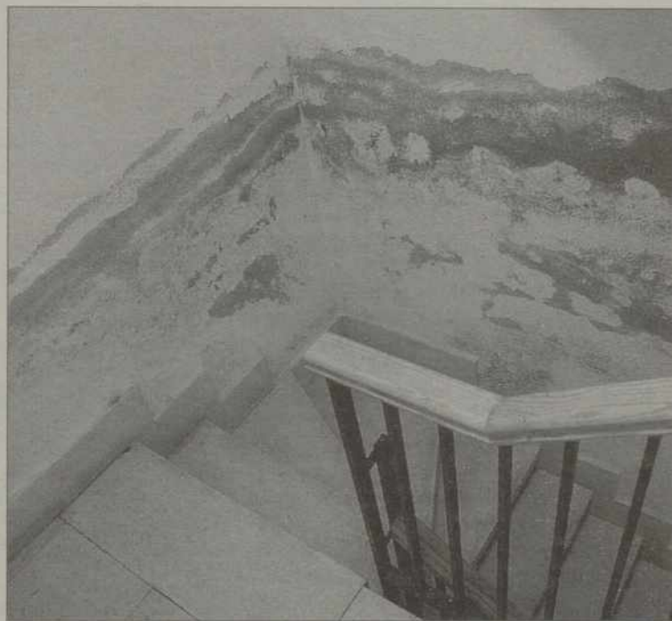
Entre los desperfectos del edificio destacan las humedades. / R. VIADERO
