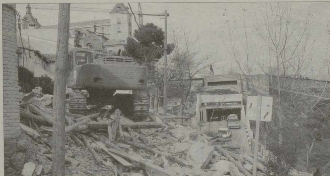
Las viviendas del Corralillo de San Miguel fueron derruidas el pasado jueves. /YOLANDA LANCHÁ
