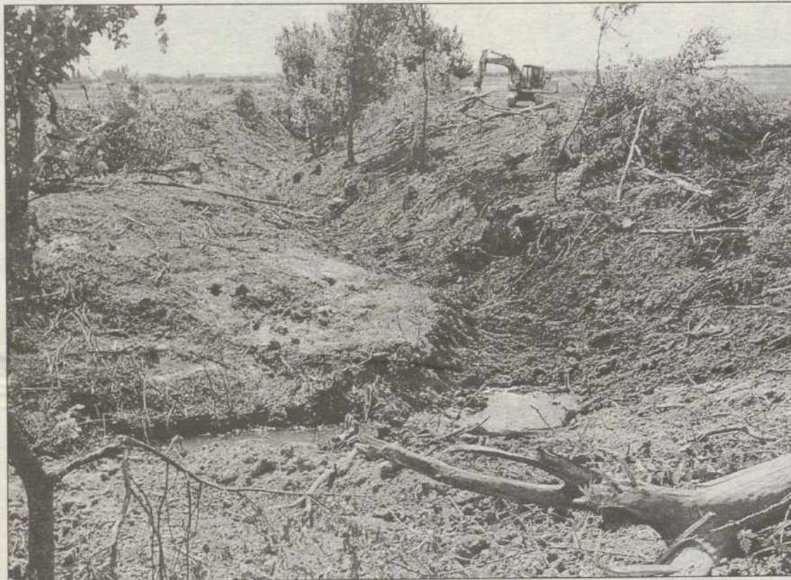
Imagen del Arroyo del Otero que muestra la excavación del lecho y arranque indiscriminado de vegetación
