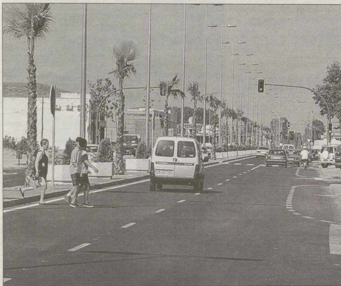
Transcurrido más de un año, las obras de remodelación están prácticamente finalizadas
