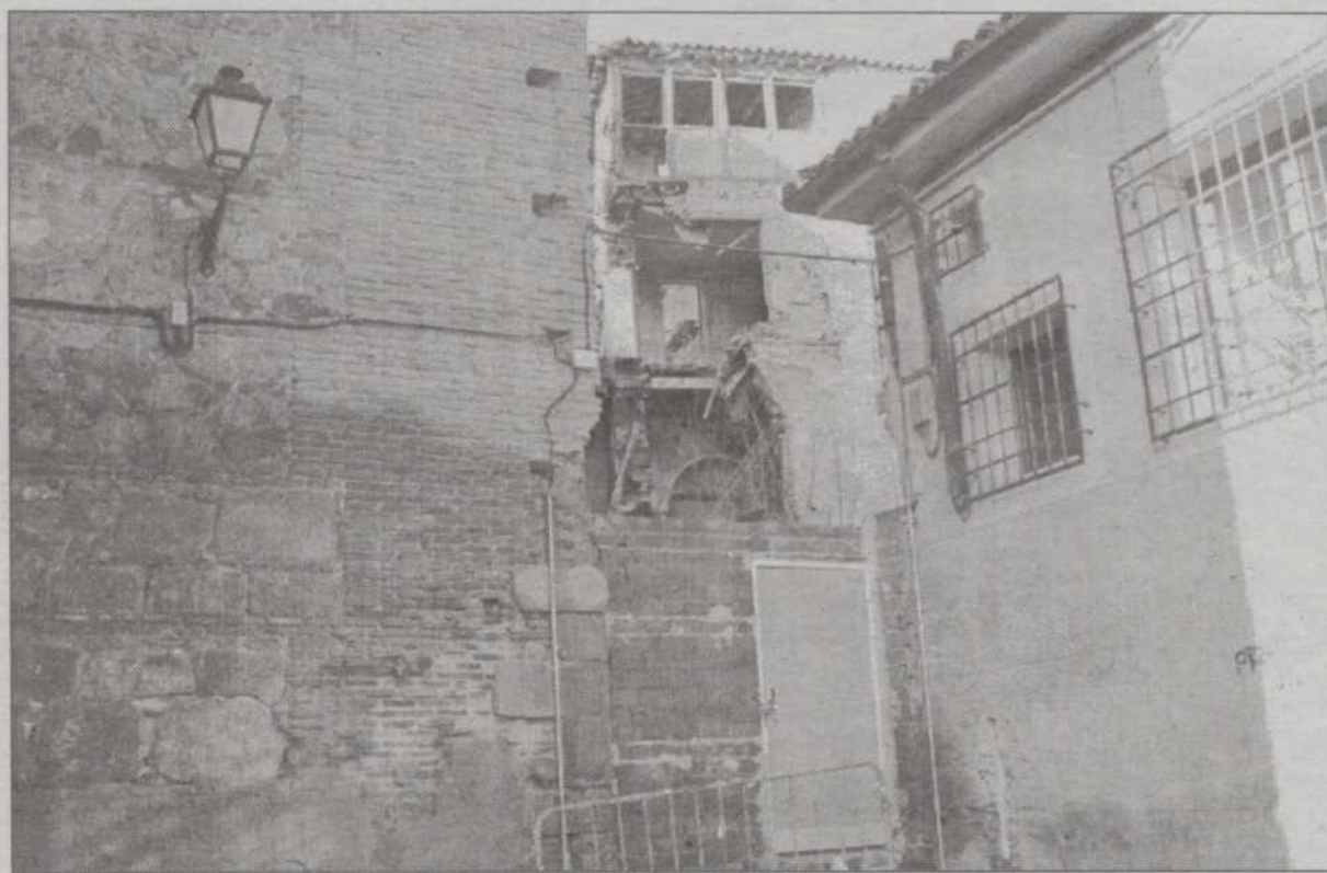
Dos casas del casco histórico de Toledo reciben esta subvención a fondo perdido.
