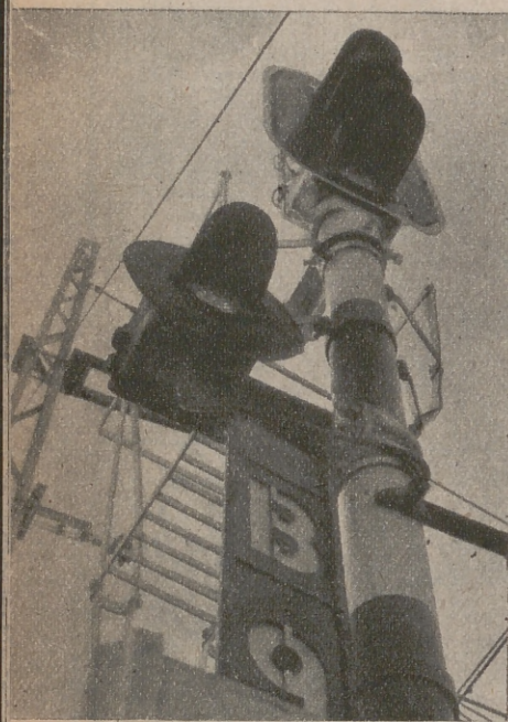
Nuevas señalizaciones luminosas
