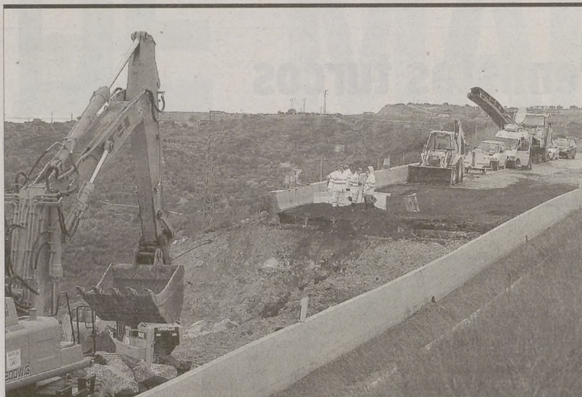
Socavón en la autovía Madrid-Valencia. La A-3 permanecía ayer cortada al tráfico a la altura de la localidad madrileña de Perales de Tajuña mientras proseguían los trabajos de reparación del socavón provocado por las lluvias en el kilómetro 39 en sentido Valencia. Fuentes de Fomento indicaron que está previsto que el tráfico pueda ser restablecido hoy, día en el que comienza la Semana Santa. / FOTO: F.V. (EFE)
