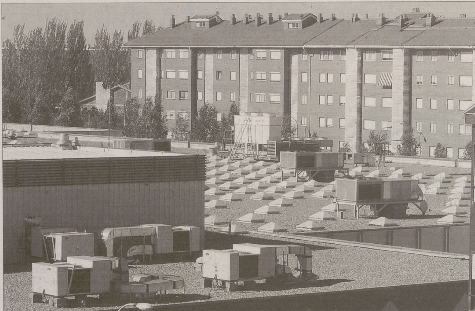
Un edificio con varias torres de refrigeración para evitar problemas con la legionella. / PABLO REQUEJO
