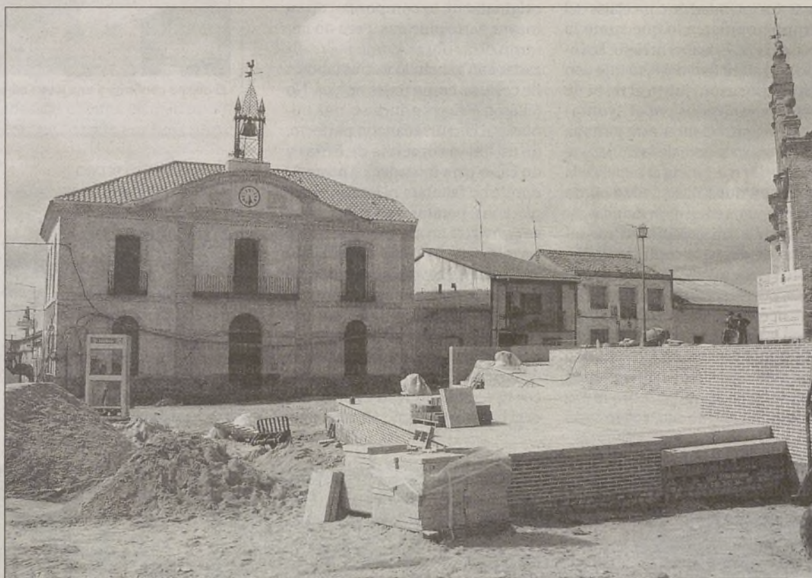
Imagen del estado de las obras en la plaza y el entorno de la iglesia de Adanero. / M. M. E.
