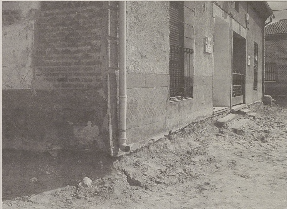
Imagen del edificio afectado por las obras en la plaza de Adanero. / M. M. E.
