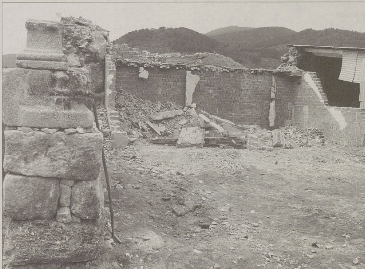
Los trabajos de demolición de la vivienda estaban ayer casi concluidos por parte del promotor. / LACABA
