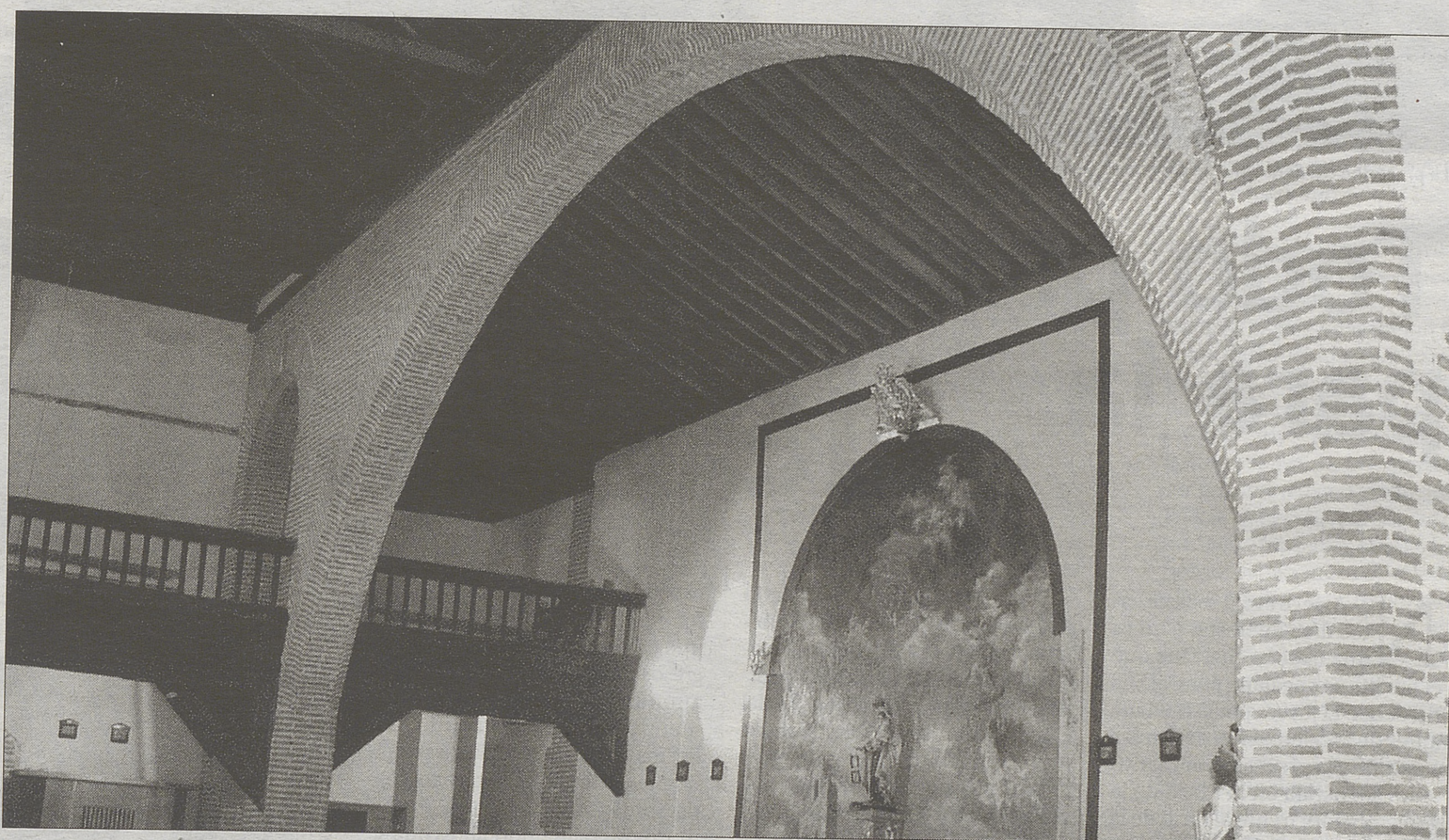
Imagen del arco central de ladrillo en la iglesia parroquial de Nava de Arévalo, recientemente descubierto, y el mural de Andrés Rueda. / M. M. E.
