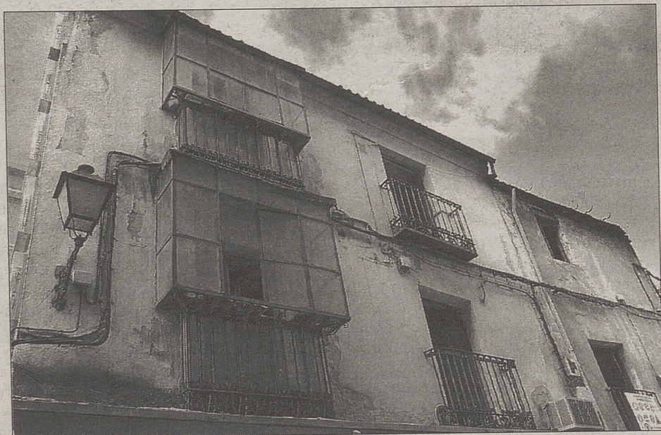
Aspecto actual de una de las viviendas de la calle Estrada. / ENRIQUE
