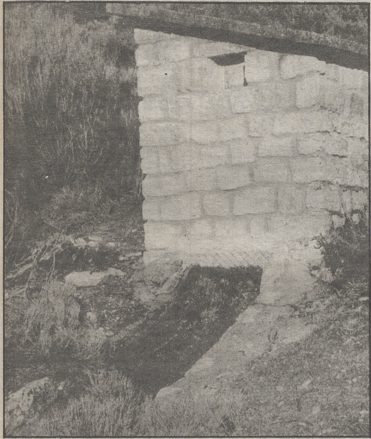
La fotografía muestra el agua que se pierde en uno de los registros de la conducción de Río Mayor. Esta conducción no ha sido revisada, pese a conocerse la necesidad que había de este agua.
