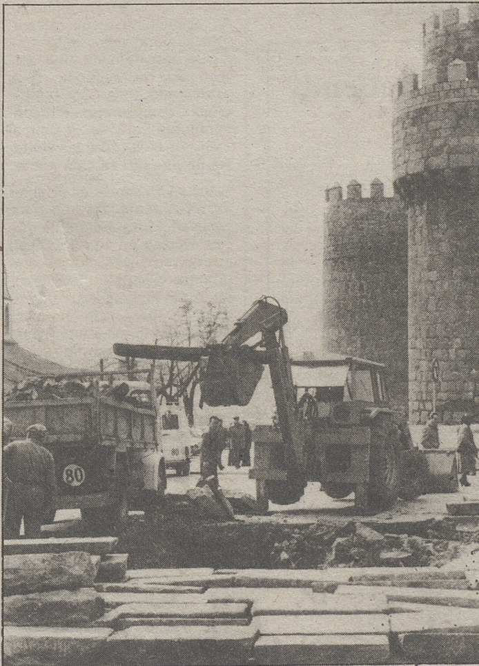
Un hundimiento en lo que fue sótano de una casa ha obligado a afianzar el firme en la calle de San Segundo. LUMBRERAS
