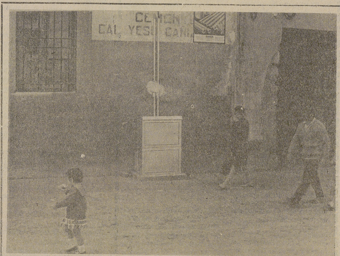
Una caja-registro metálica ha sido instalada en la plaza de Navillos, quitando a los peatones un trozo de acera. Indudablemente, este registro será necesario, pero podría buscarse para él un lugar en el que no estorbe a los viandantes.—(Foto: LUMBRERAS).
