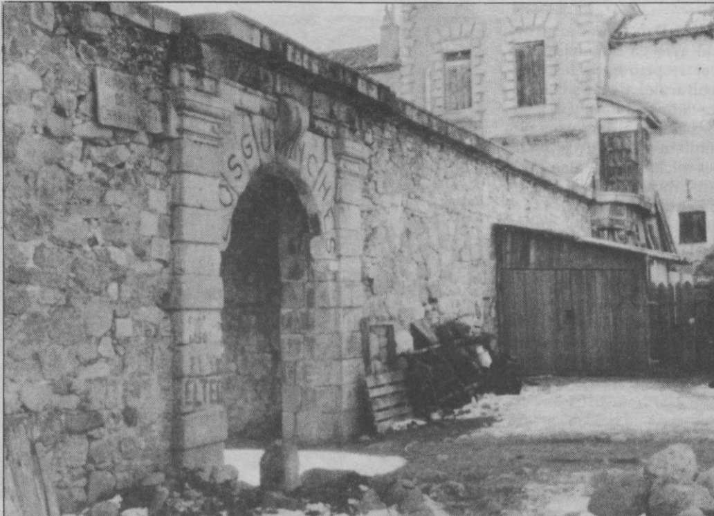
El arco de entrada al Patio de Vaca necesita una urgente intervención debido a su mal estado. J.C.M.R.
