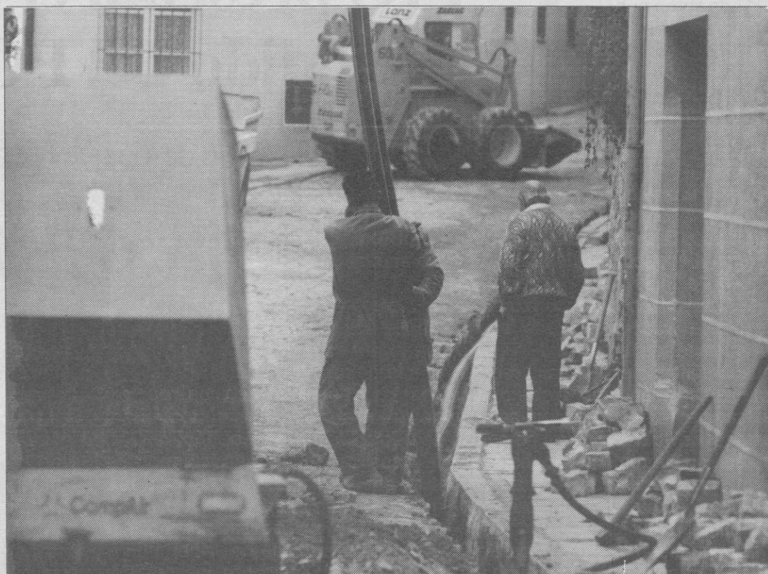
Si las obras las hubiera realizado una empresa segoviana, primero hubiera tenido más cuidado en dejar todo como estaba y segundo no la habrían permitido dejar las calles en tan mal estado.
