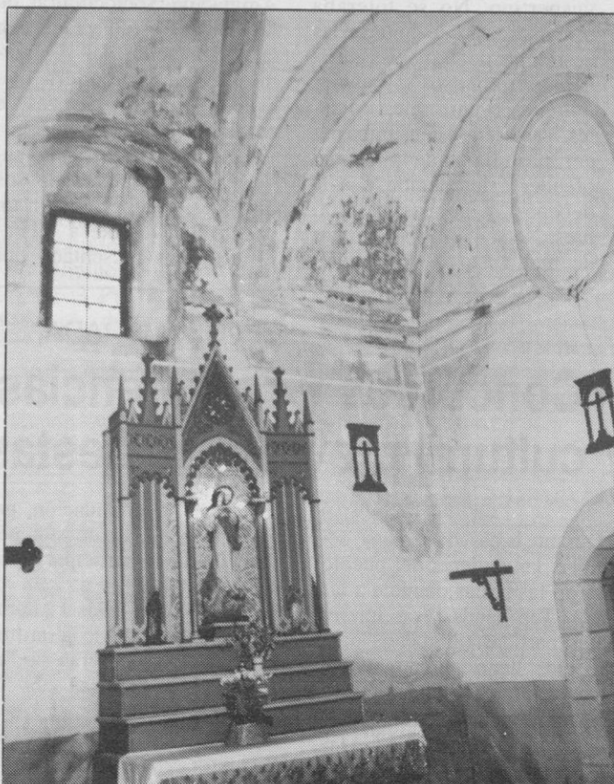
Las goteras están invadiendo el templo de Torrecaballeros.
