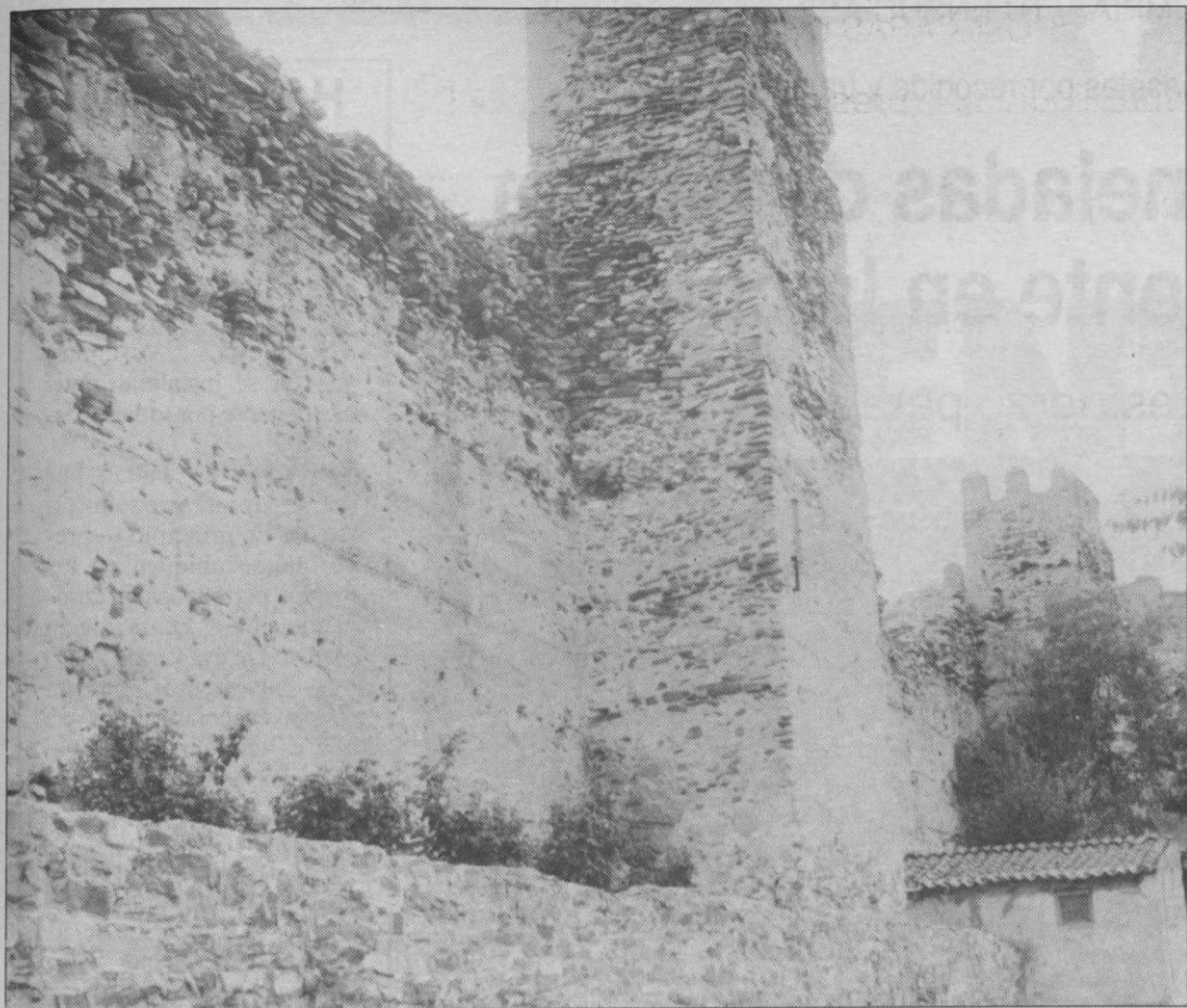
Las murallas del municipio muestran un estado de abandono con peligro de desprendimientos.
